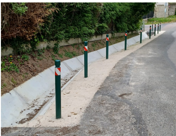
Caniveau sur la rue Alexandre Laurent rendu nécessaire par le ruissellement lors de pluies abondantes (caillebotis à venir très prochainement).
